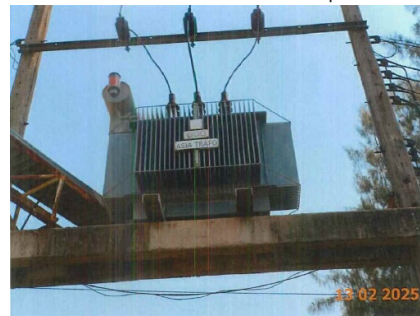
หม้อแปลงไฟฟ้า
